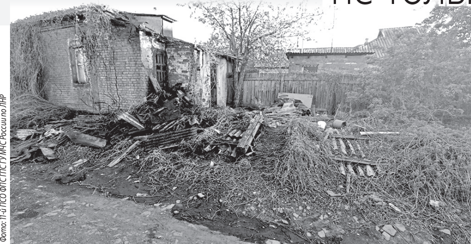
После пожара на ул. Куйбышева
