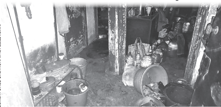
► Последствия пожара на ул. К. Либкнехта
