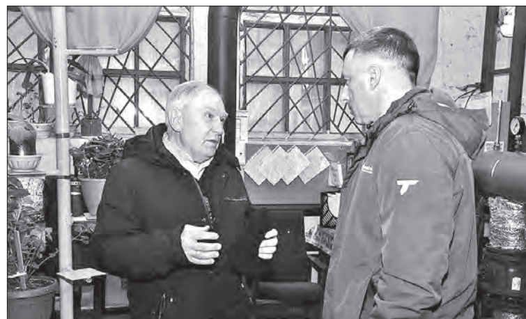
► Андрей Сухачев (справа) в котельной ДК им. Свердлова
