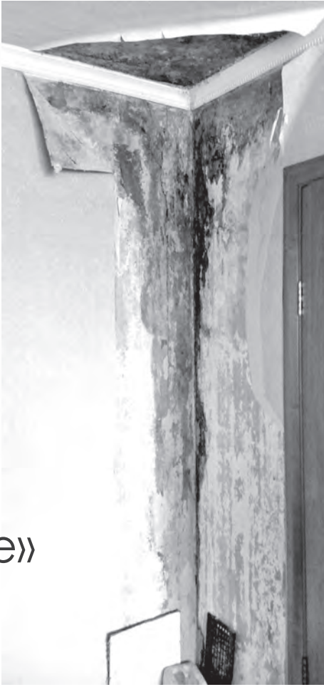
► Вода бежит по углам квартиры
