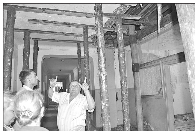
Крыша на здании амбулатории рискует обвалиться
