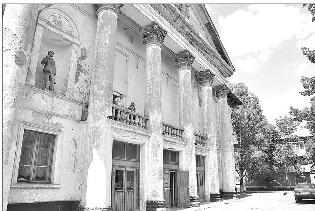
ДК пос. Комсомольский: отопления нет, фасад обваливается
