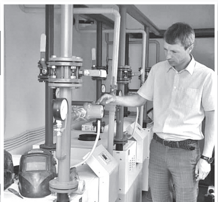
Анатолий Мартынюк проверяет готовность школьной котельной
