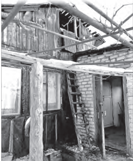
► Последствия пожара в пос. Шахтерский на ул. Кутузова
