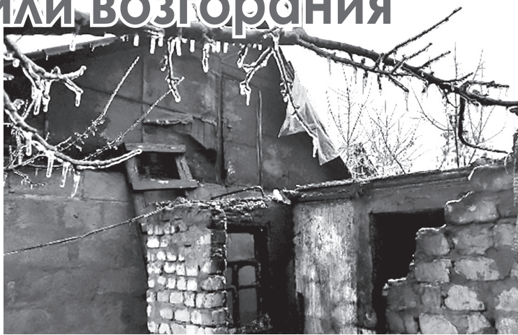
► Последствия пожара на ул. Б. Хмельницкого
